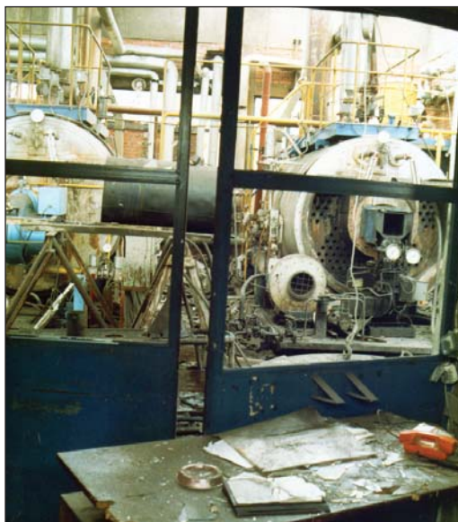
Oštećena proizvodna postrojenja
