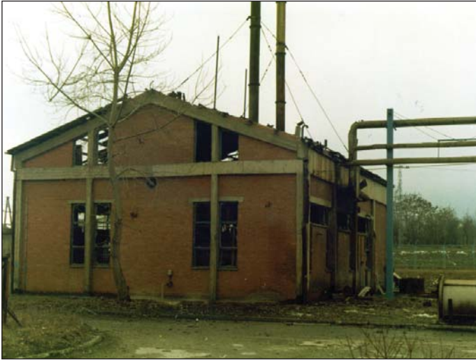
Kotlovnica nakon granatiranja
